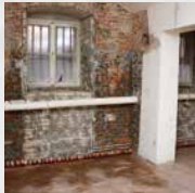
bij vochtig metselwerk
