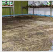
niet dampdicht beton
